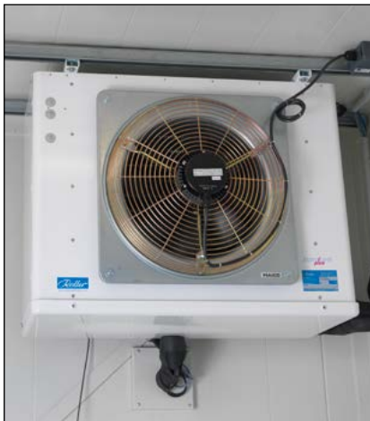
Climatisations split avec groupes frigorifiques (vue intérieure)
